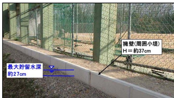
図 5-3. 貯留施設整備後 (県立北摂三田高等学校)
