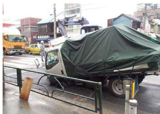
図 3-11. 道路陥没被害写真(他市事例) 出典：国土交通省 HP
