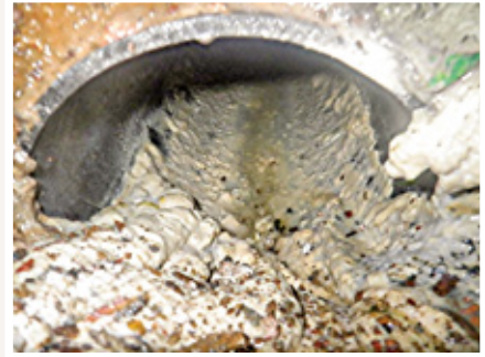
油が固まりつまった下水道管
