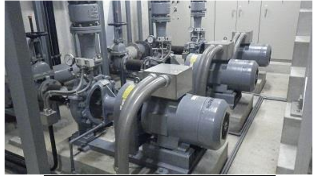
送水ポンプ 浄水池に貯めた水道水を配水池へ送り出すためのポンプです。
