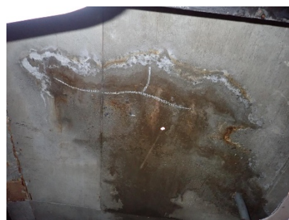
床版にひびわれ、遊離石灰が見られます
