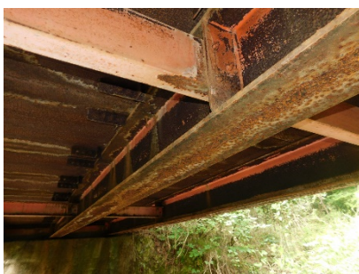
鋼桁の腐食が見られます
