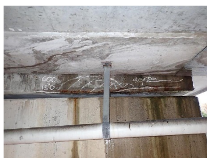
コンクリート橋の主桁にひび割れが見られます
