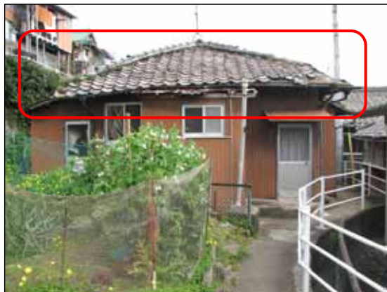
屋根に不陸がある例
