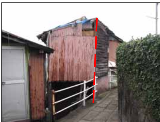
一部の柱が傾斜している例
