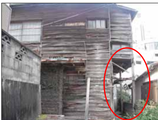
柱の数箇所に破損がある例
