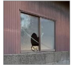
窓が割れた管理不全空家
