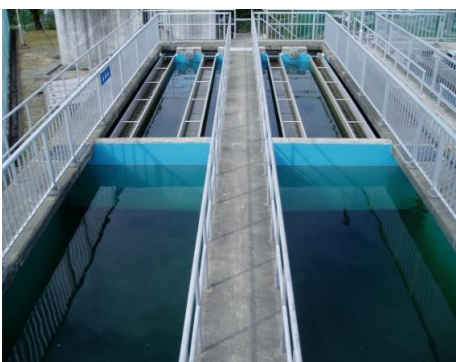
薬品沈澱池 凝集剤(ポリ塩化アルミニウム)を注入します。原水中の浮遊物は汚れの固まり(フロック)となり沈みます。
