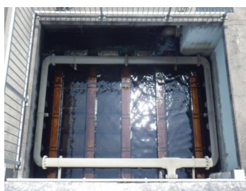
急速ろ過池 沈澱池で取り除けなかった小さなごみを砂の槽でこしてきれいな水にし、浄水池に貯めます。
