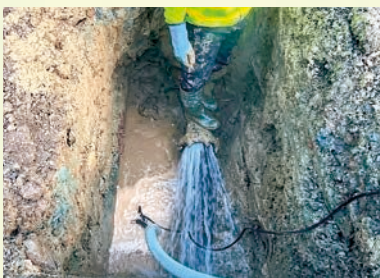
地震による揺れや地盤の崩壊により、地震に弱い水道管が破損することがあります。 (令和6年1月能登半島地震における事例)
