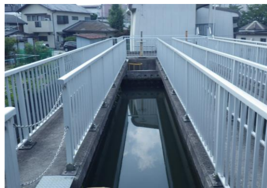
沈砂池 大きなごみや砂を沈め取り除きます。
