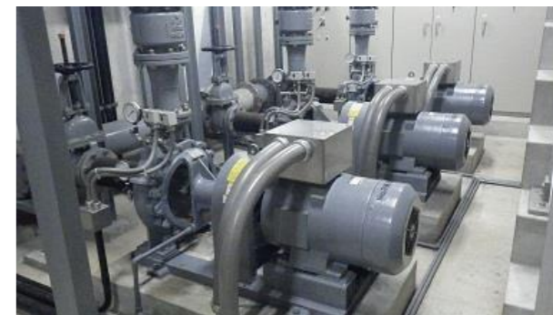
送水ポンプ 浄水池に貯めた水道水を配水池へ送り出すためのポンプです。
